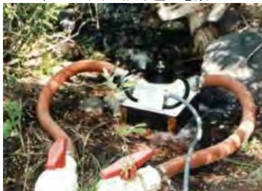
2本ノズルタイプ(山小屋の電源)
